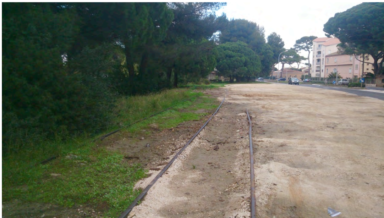
Etat de la voie en gare de La Plage d'Hyères
