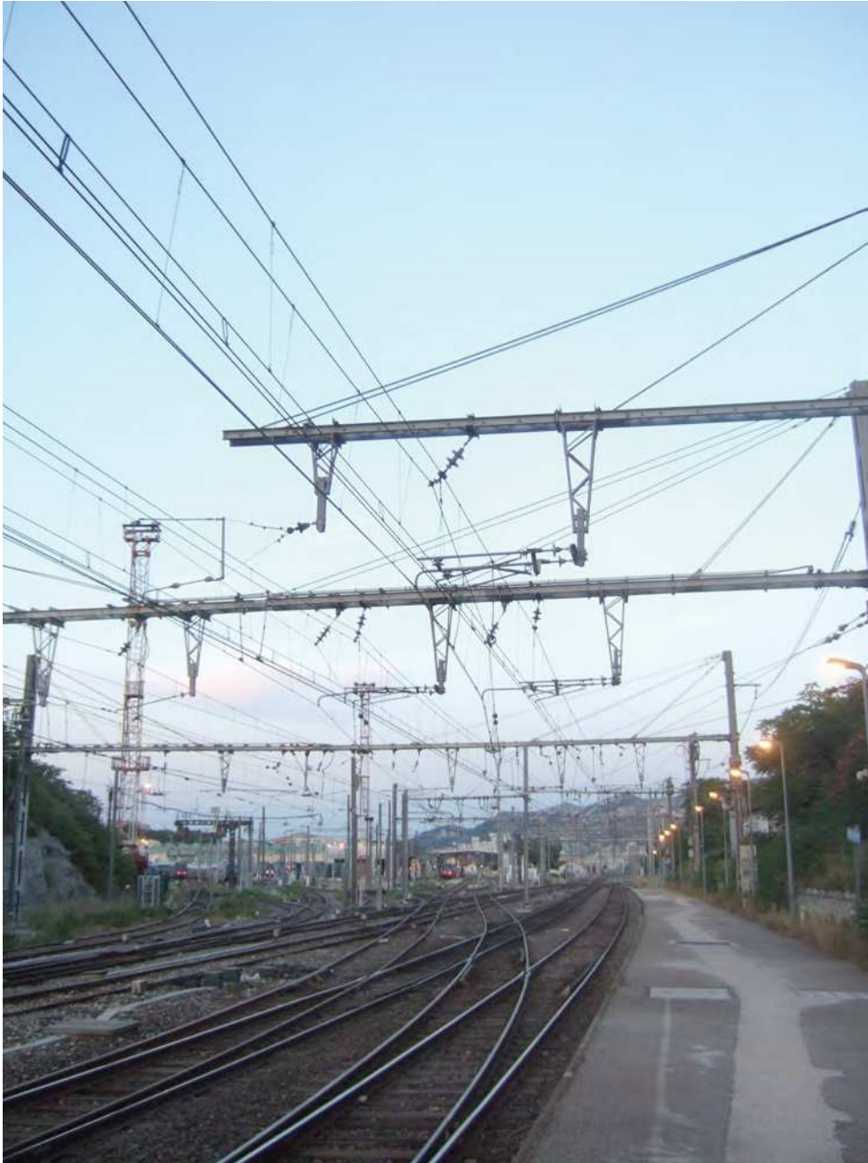
Dans la zone des appareils de voies de Blancarde
